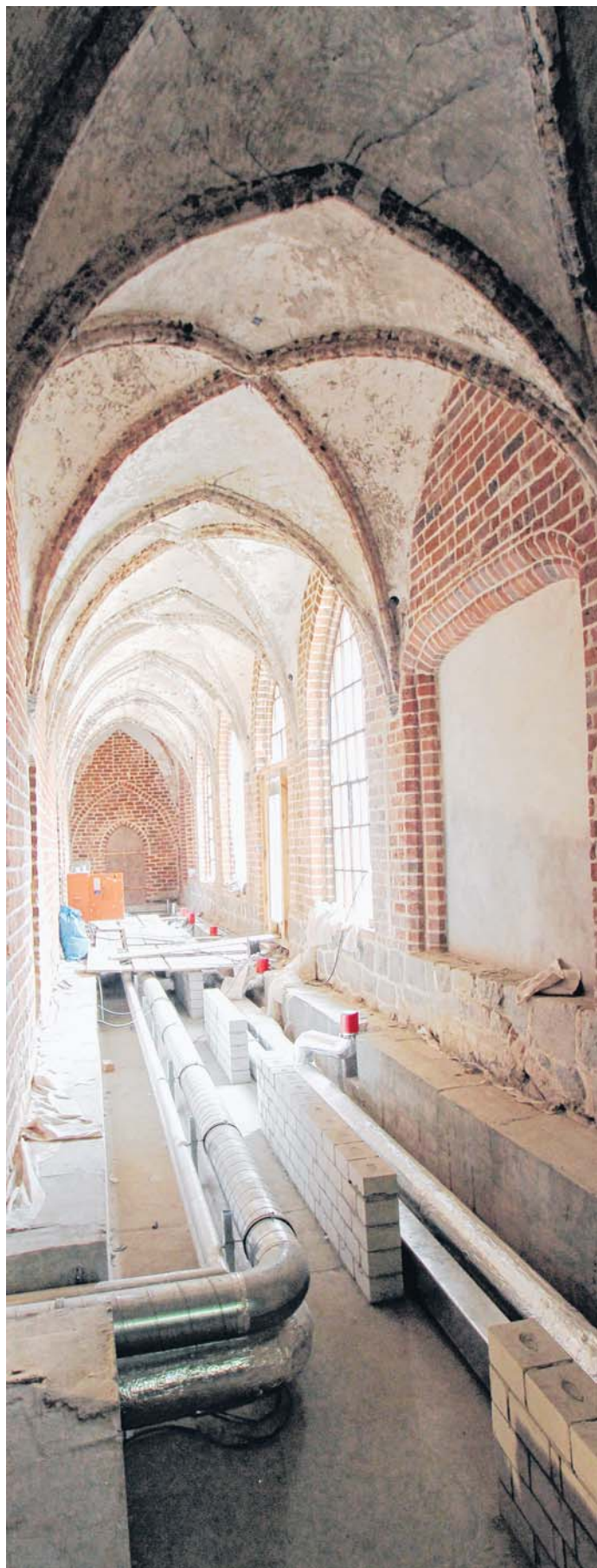
Nachdem die Bodendenkmalpfleger jedes Körnchen untersucht haben, werden nun Versorgungsleitungen im Boden des ehemaligen Kreuzgangs des Franziskanerklosters verlegt.
