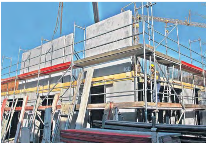
Aus dem Untergrund: Über dem Dach der Tiefgarage wächst der HKB-Saal in die Höhe.
